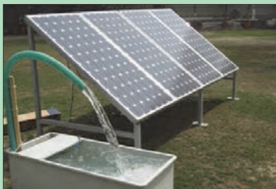
شکل ۳۸- کاربرد سامانه فتوولتاییک در پمپ چاه آب
