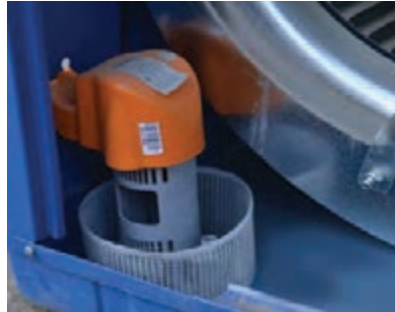
صافی آب و پمپ
