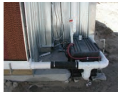
تصویر ۱۲-۲ - پمپ و لوله های توزیع آب
