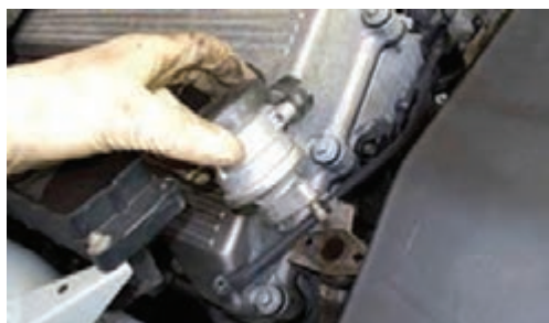
باز کردن شیر کنترل پمپ دمنده
