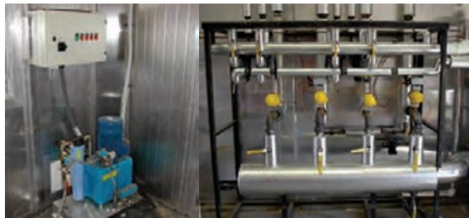
شکل ۶۰- شیرهای کنترل بخارزنی
