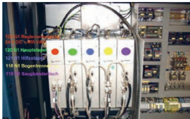
شکل ۴۴- پنج عدد درایور برای کنترل کله گی آپارات
