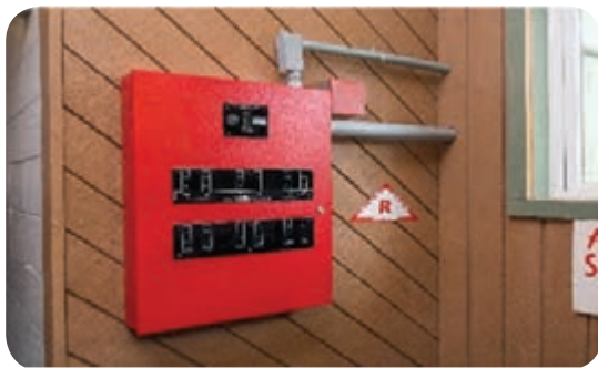
شکل ۳-۴۹- تصویر تابلو کنترل
