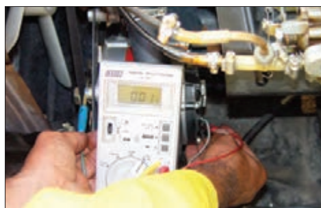
شکل ۳۰- آزمایش اجزای داخلی آلترناتور
