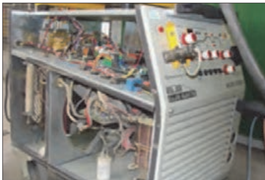
شکل ۱۱- ساختمان داخلی رکتیفایر
