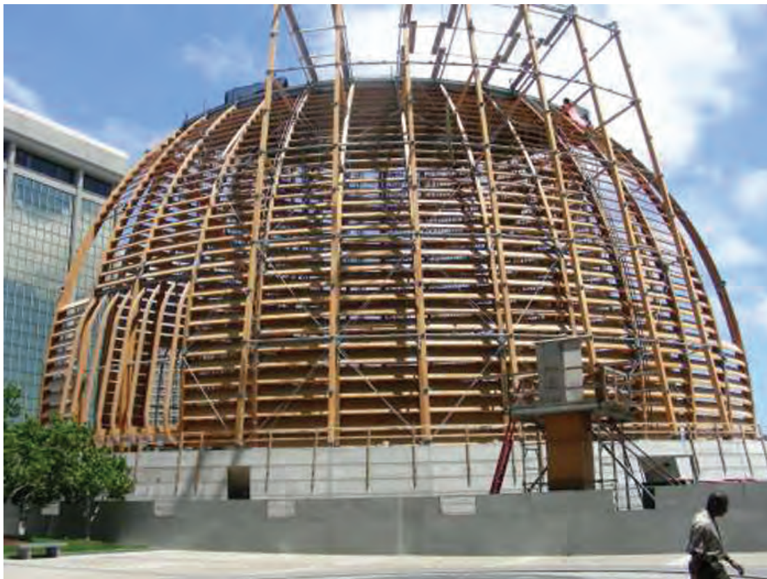
شکل ۵-۶- نمای اسکلت یک گنبد چوبی که سقف یک استادیوم ورزشی را می پوشاند.
