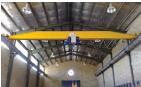
شکل ۲۱- نمایی از جرثقیل سقفی (تک پل)
