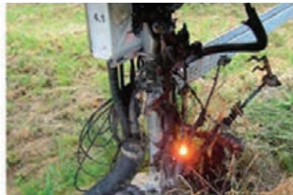
شکل ۳۶- سامانه فتوولتائیک بدون اتصال زمین که منجر به آتش سوزی شده است.
