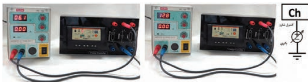
شکل ۱۸- تست کنترل شارژ
