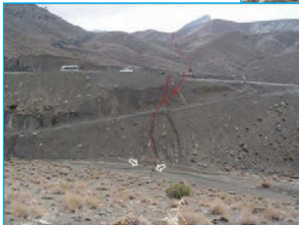
شکل ۲۵-۱- شکاف ناشی از زلزله داهونیه زرنده سال ۱۳۸۳
