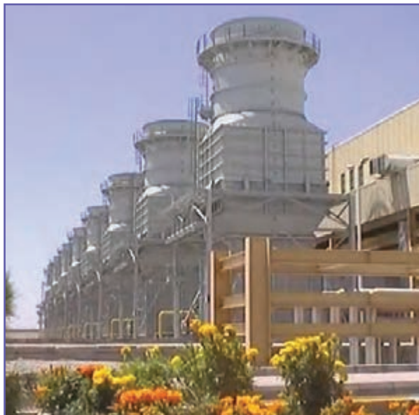
شکل ۶-۵- نیروگاه سیکل ترکیبی کرمان
