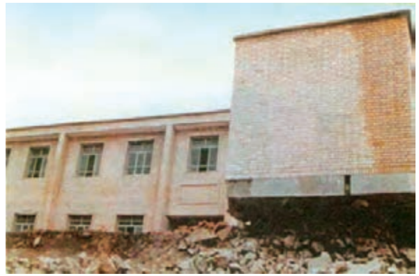
شکل ۱-۶۲- ساختمان دبستان روستای ناوه پس از زلزله
