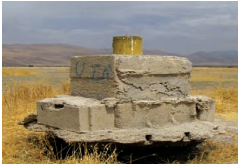
تصویر ۸-۴- پدیده فرونشست زمین (منطقه خانمیرزا)
