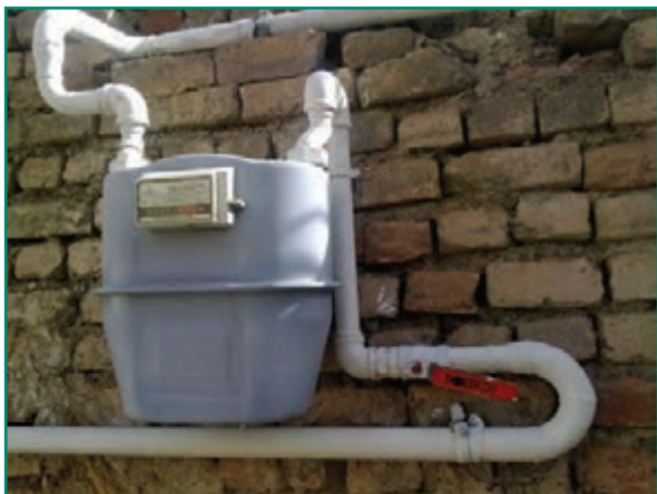
شکل ۸۱-۴ یک کنتور ۱۰ متری نصب شده
